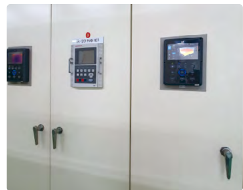
배전반 내 설치
